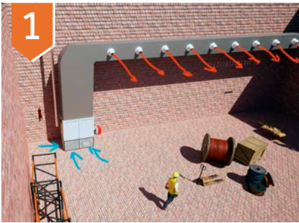
1 Generador de aire caliente con impulsión de aire mediante conductos y conos de alta inducción.
