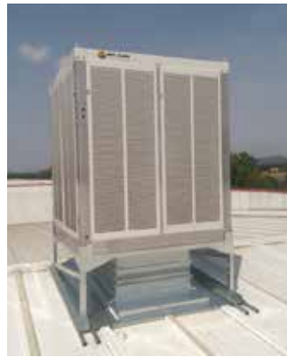
AD- 40-V en nave industrial
