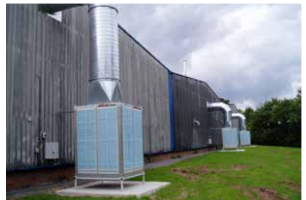
Instalación AD-40-VS con prefiltro G4 en nave industrial
